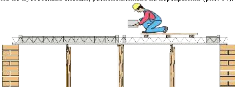
Рис. 14 Монтаж пустотелых блоков перекрытия с рабочих помостов, находящихся с верху и расположенных перпендикулярно балкам перекрытия
